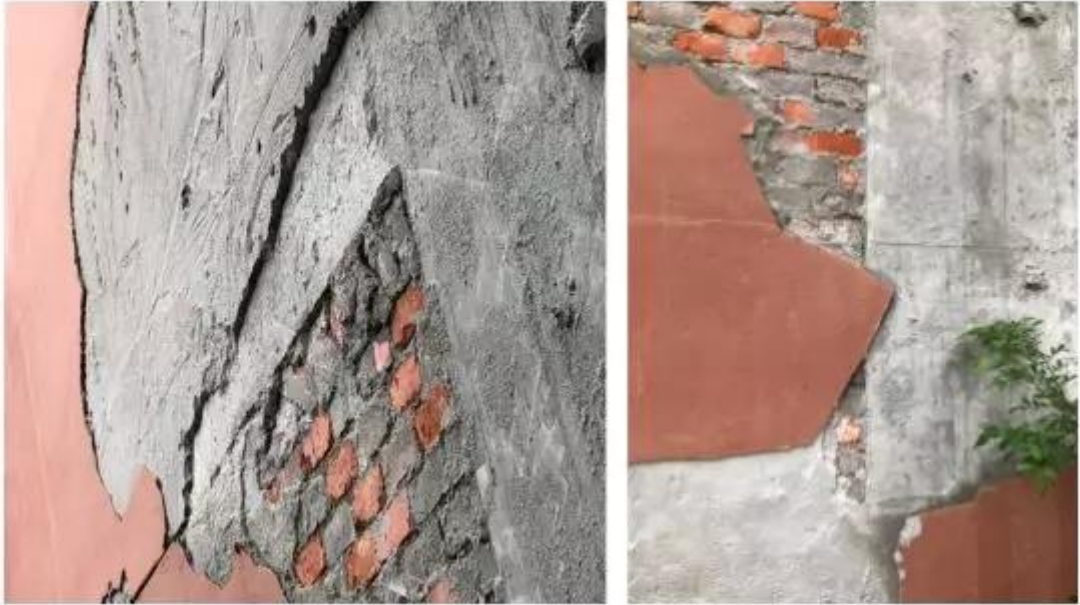
外墙未设置砂浆找平层，玻化微珠保温层厚度不均，空鼓严重。
